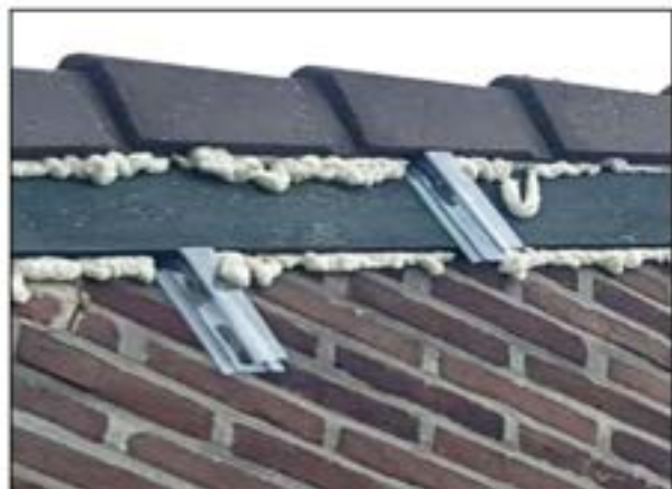
Figuur 8. Aangebracht vulschuim en exclusion flaps (bron: Unitura, 2021)
