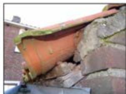
Figuur 19. Opening onder dakpannen woning.
