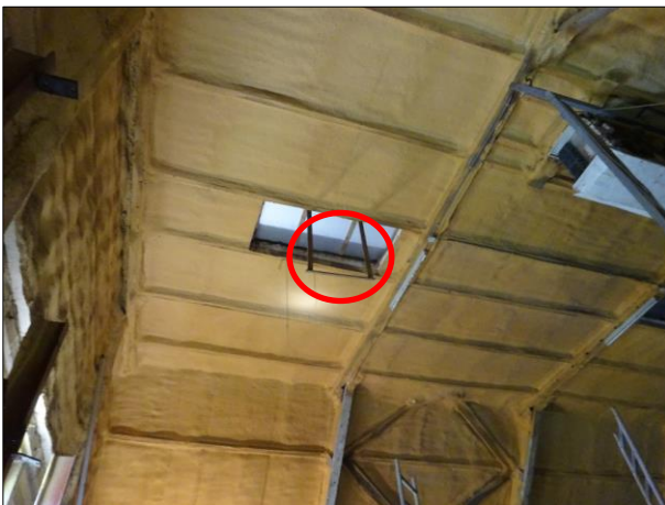
Figuur 4.3. Potentiële roestplaats binnen de schuur.
