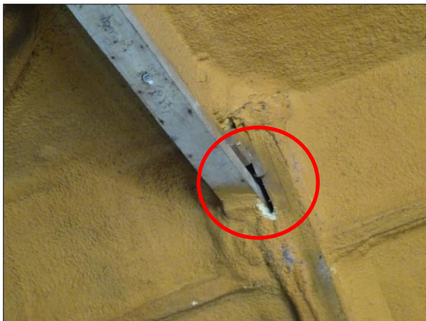
Figuur 4.6 Aanwezige kier tussen isolatieschuim en balkstructuren.
