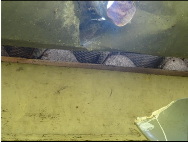
Figuur 4.4 Onderzijde golfplaten gedicht met voegwerk.
