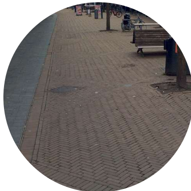
Verzakking van bestrating t.o.v. lijngoot door verschillende fundaties.
