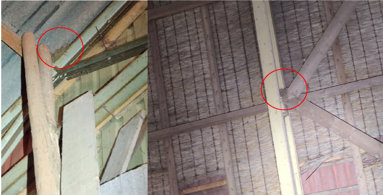
Figuur 4.15 Aangetroffen nest van algemene broedvogel in één van de asbest schuren (links). Eén van de twee aangetroffen nesten in de domeinschuur (rechts). Beide zijn voor verduidelijking rood omcirkeld.
