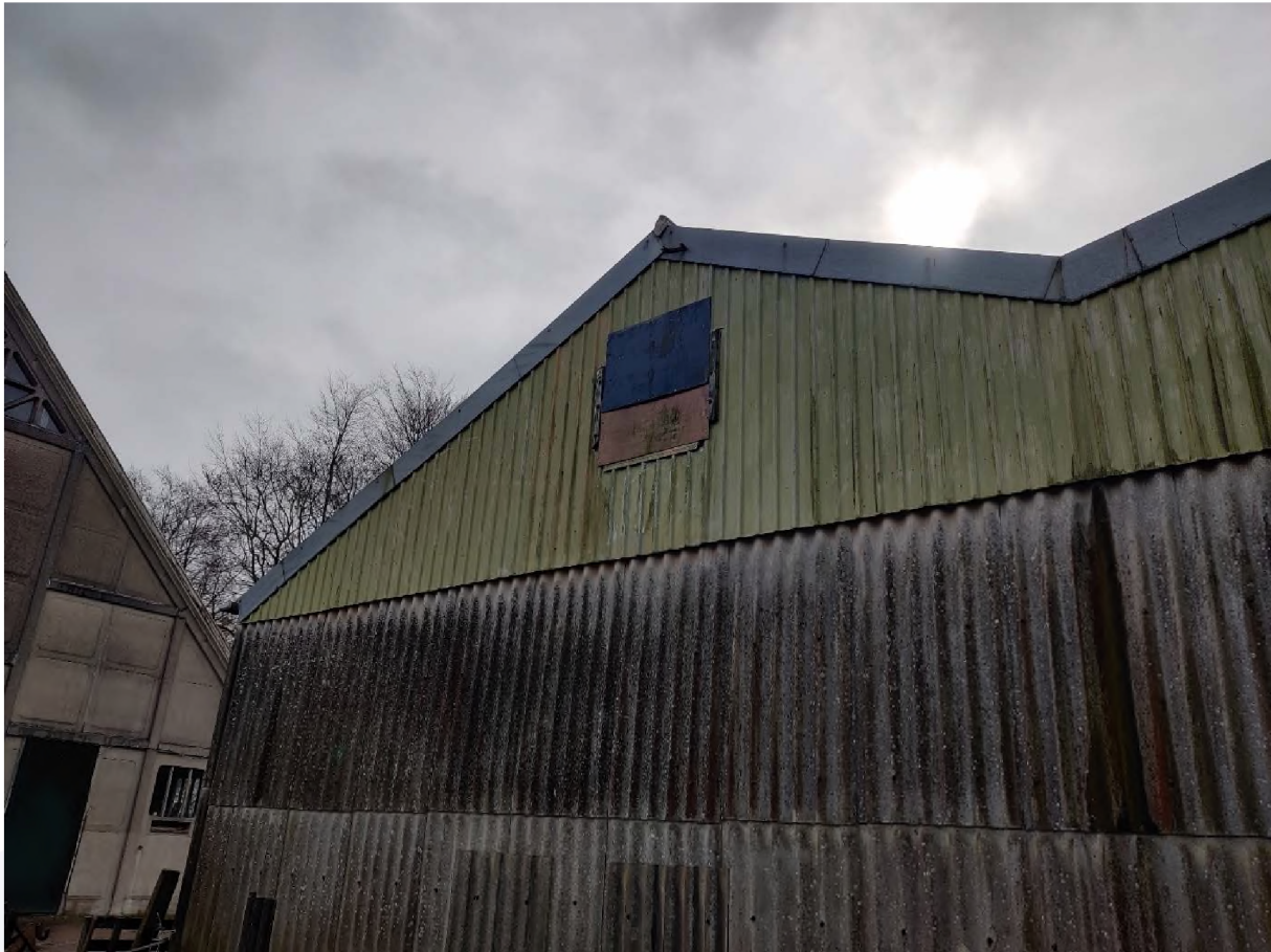
Figuur 4.2 Zuidwest kant van de twee grote asbest schuren met aanwezige metalen en asbest beplating
