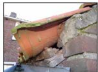
Figuur 19. Opening onder dakpannen woning.
